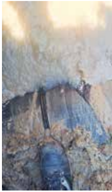
Schadstelle an der Kanalleitung
