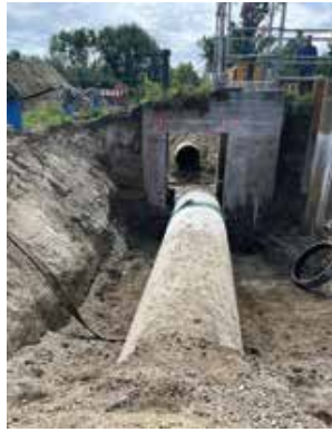
Spannungen auf der Bestandsleitung
